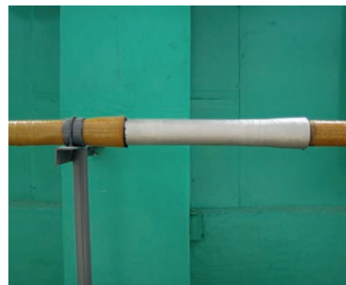
ПХР встроены на резьбовом соединении в разрыв стеклопластикового трубопровода
